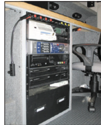
Conjunto de equipos montados en la cremallera.
